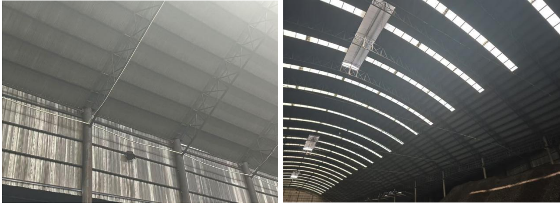
储煤棚喷淋设施
